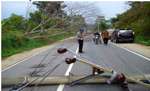
Gambar 3.3 Tiang Roboh Akibat Tertimpa Pohon
